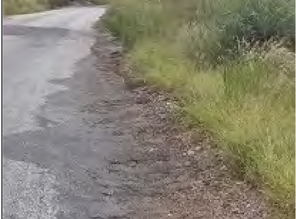
対象道路の現状 路肩部のダメージ例
