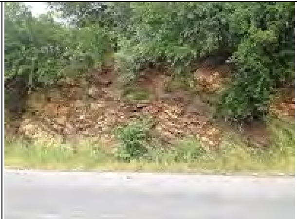
対象道路の現状 切土法面の状態(風化岩や礫混じり土砂)
