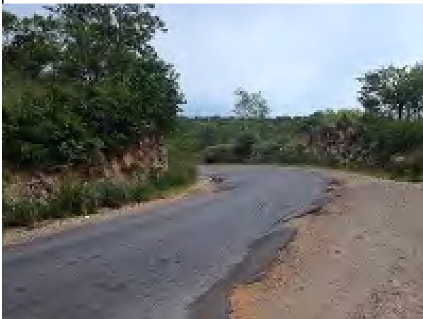
対象道路の現状 路面と路肩のダメージ状況
