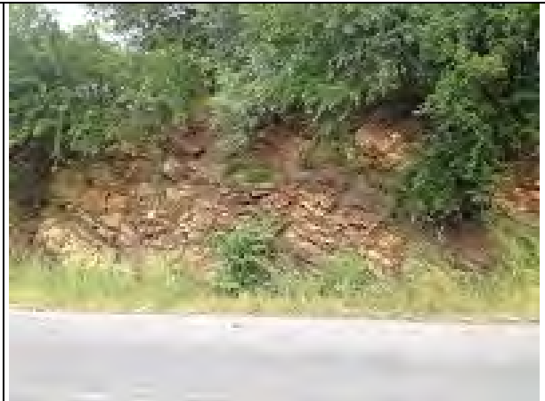
対象道路の現状 切土法面の状態(風化岩や礫混じり土砂)
