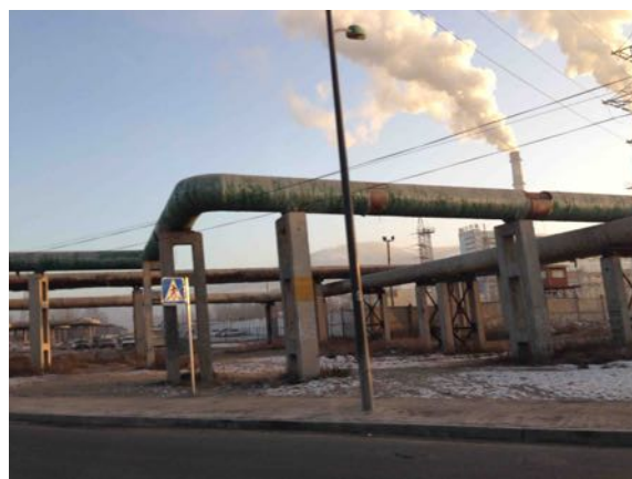
写真 7 集中暖房用熱水パイプライン
