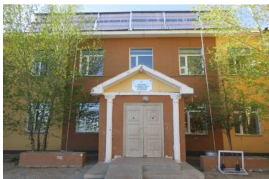
校舎の屋根に設置された太陽熱集積コレクター
