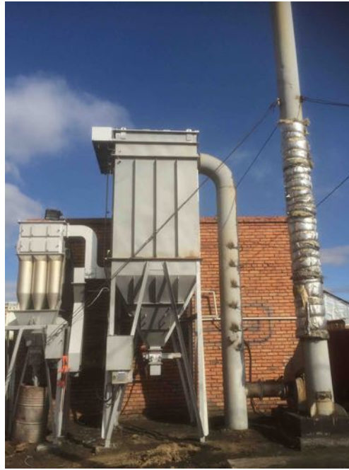
写真 9 日本企業が設置したバグフィルター
