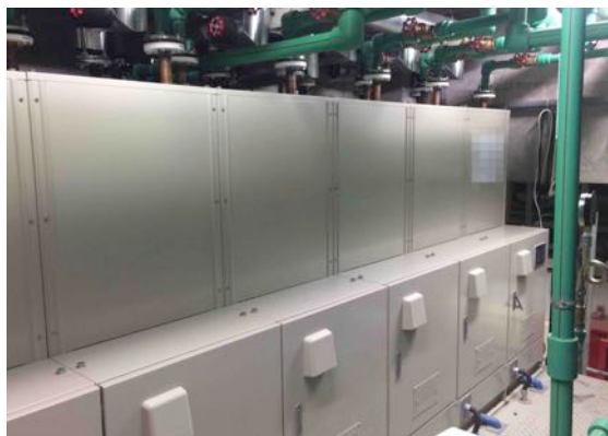
ゼネラルヒートポンプ工業社製の ヒートポンプ
