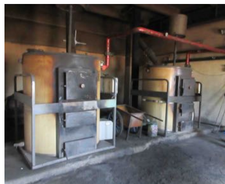
韓国製の温水給水ボイラ (HOB)
