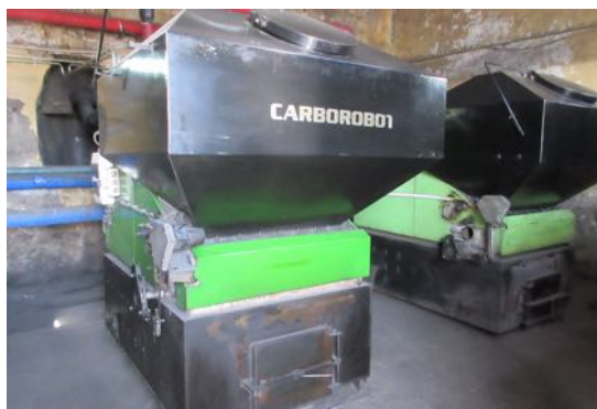
ハンガリー製の温水給水ボイラ (HOB)
