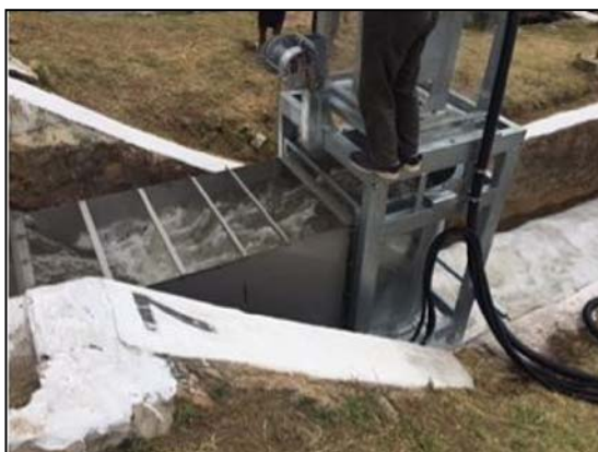
図 3-1-18 アングル取付部の破損
