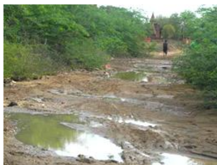
図 1.1 ぬかるんだ域内道路の路面
