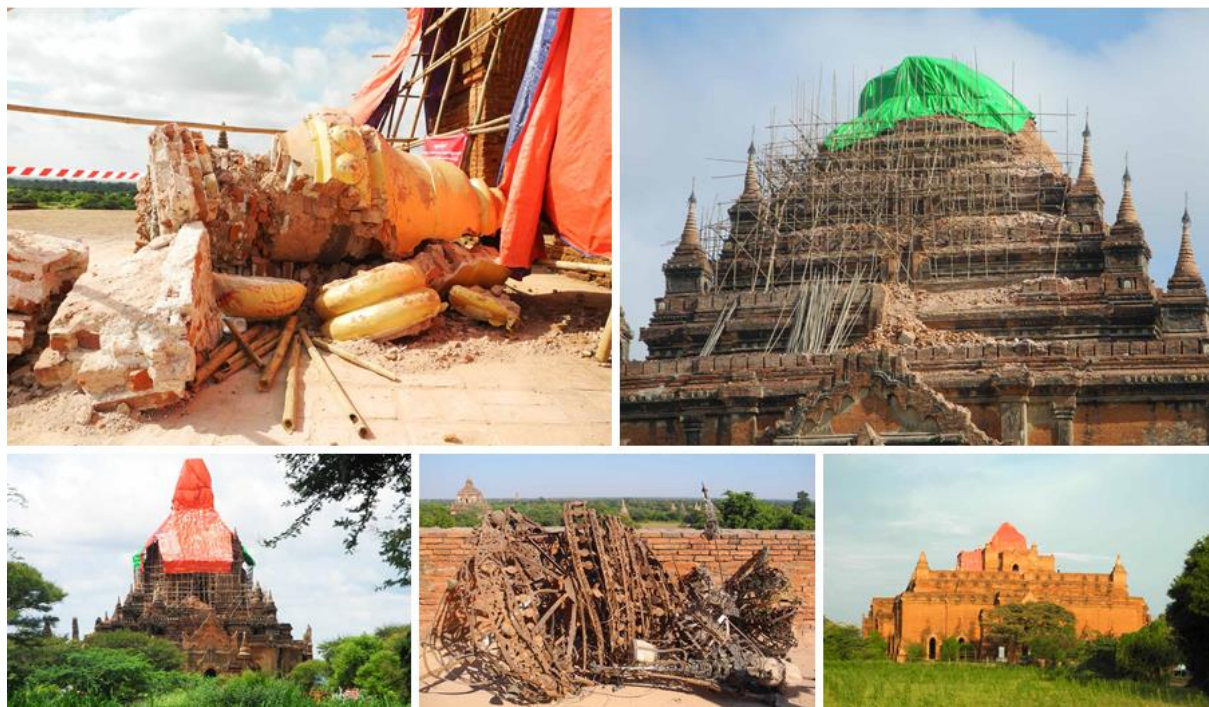
ピャタダ寺院／スラムニ寺院／タヨウピュー寺院／スラムニ寺院の崩落したアンブレラ／ピャタダ寺院 出典：JICA 専門家チーム
