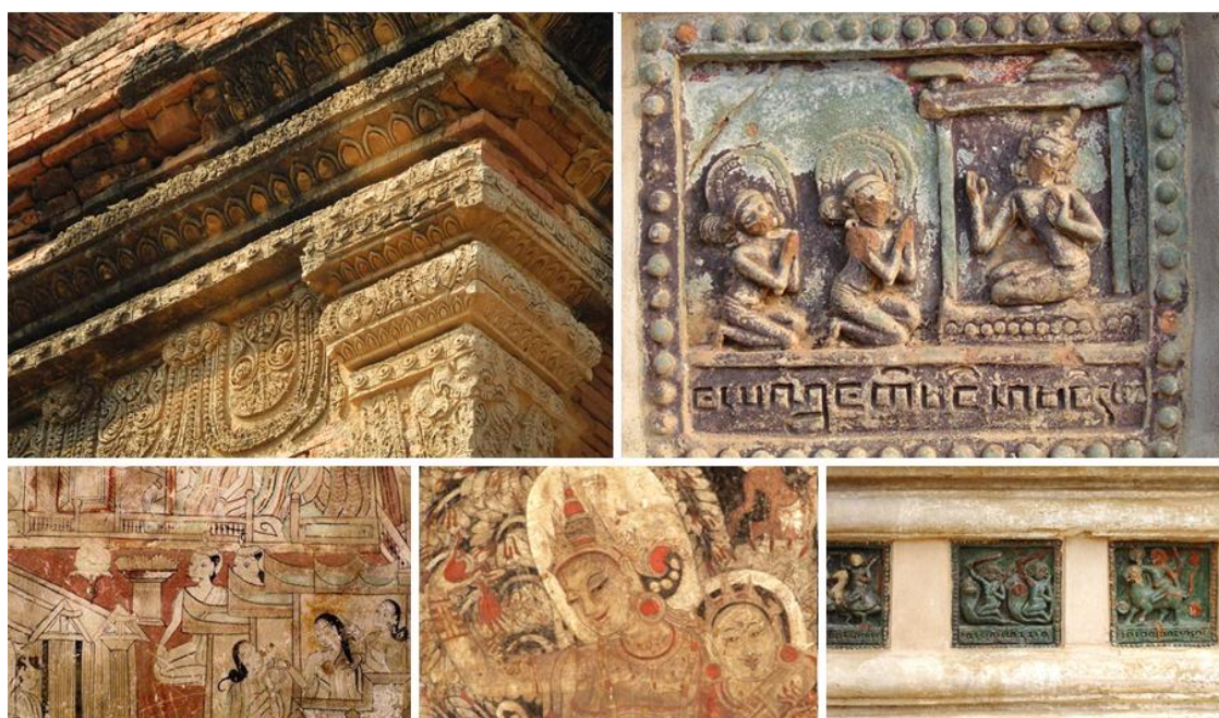
漆喰装飾の外壁／陶板レリーフ／寺院内の壁画／アーナンダ寺院の外壁に貼られた陶板タイル 出典：宗教文化省、JICA 専門家チーム
