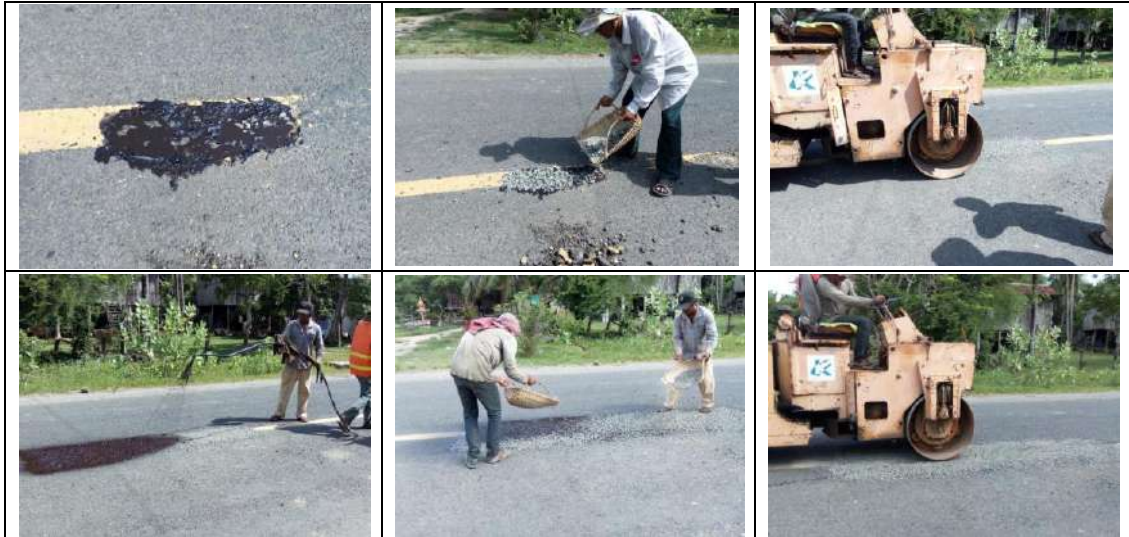
図 3.2-9 DPWT が実施している従来手法のポットホールの補修状況
