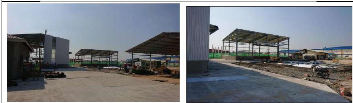
図 3.4-2 プノンペン SEZ におけるエクセル等製造プラント建設 (2018 年 2 月現在)
