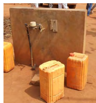
庭先に設けられたヤードタップ
