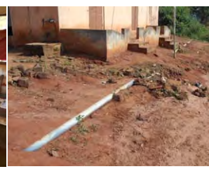
PVC φ 110mm (サケテの露出区間、水源井戸～高架水槽)
