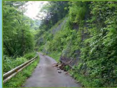
斜面の落石対策をしていた道路
