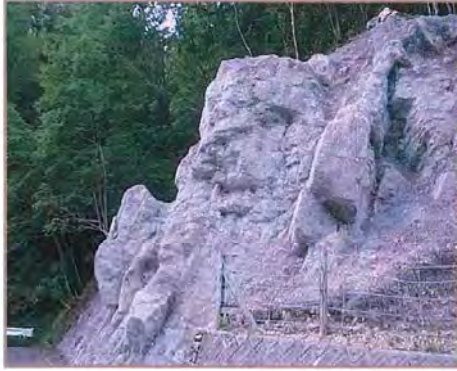
Система предотвращения камнепадов, обеспечивающая плотное прилегание сетки к склону
