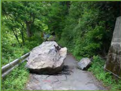
斜面の落石対策をしていなかった道路
