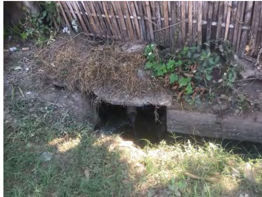
既存の排水管から道路排水溝への排水
