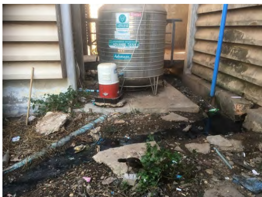
排水管の垂れ流しの雑排水
