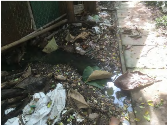
既存の排水管から地表に溢れた排水
