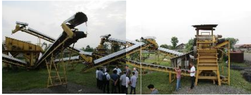
注：普及・実証事業では RAP 専用クラッシングプラントを追加する 写真 6 既設のクラッシングプラント
