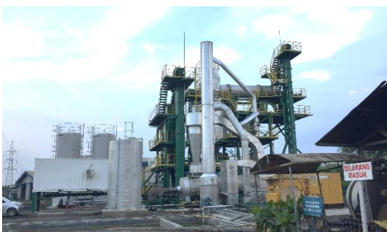
アスファルト再生プラント(2017年10月)
