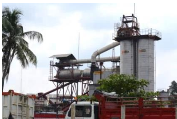
写真 3 アスファルト再生プラント（ドイツ製）
