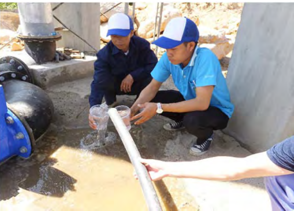
浄水場建設現場 高架水槽出口水 サンプルング 撮影日 2016年10月3日
