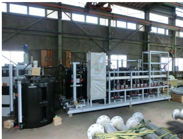
薬注ポンプ架台
