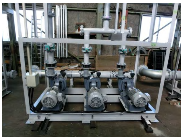
砂ろ過用ポンプ
