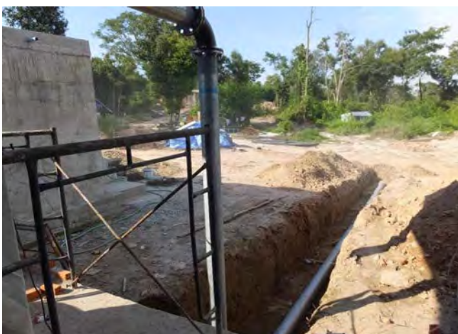
送水ポンプ～高架水槽 配管
