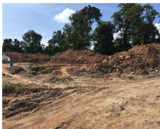
高架水槽 設置場所
