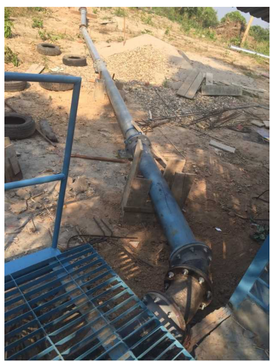
配管（取水箇所から水槽）
