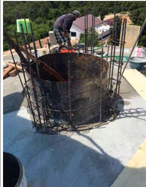
高架水槽 レベル取付座
