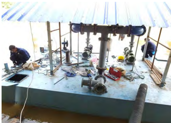
取水施設(取水ポンプ部)
