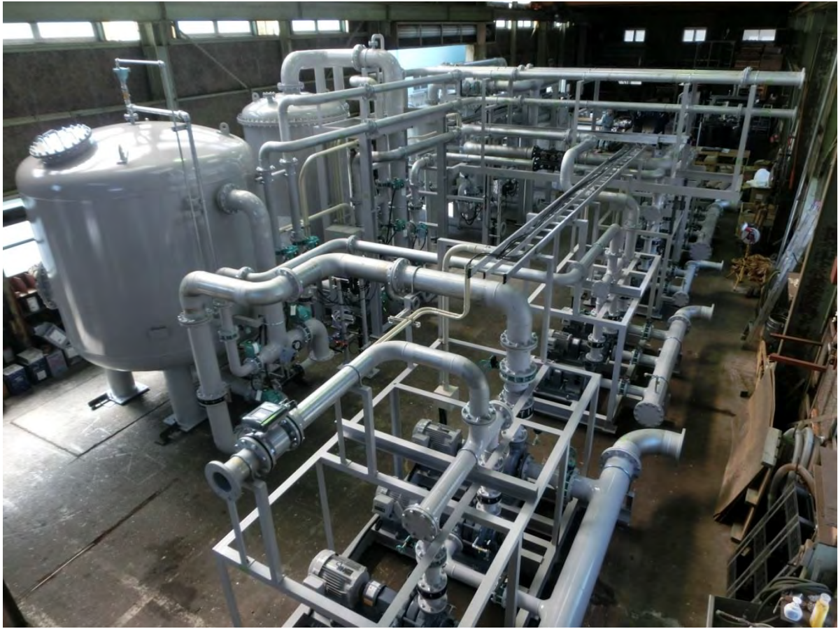
システム(砂ろ過側)
