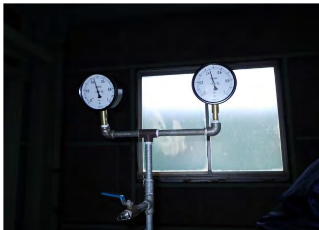
耐压検査(圧力計部拡大)
