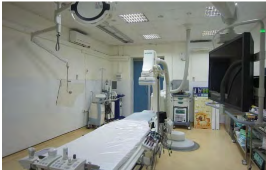
血管造影室 撮影室の様子
