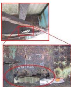
橋梁の劣化 (主に国交省HP)
