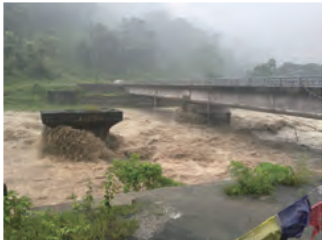
集中豪雨により増水した河川とジグミリング橋(左:古い橋脚、右:新橋)
