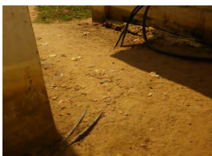
(a) OFC（地下埋設）
