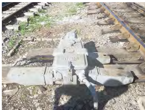
(c) 電気転てつ機 (マンダレー)
