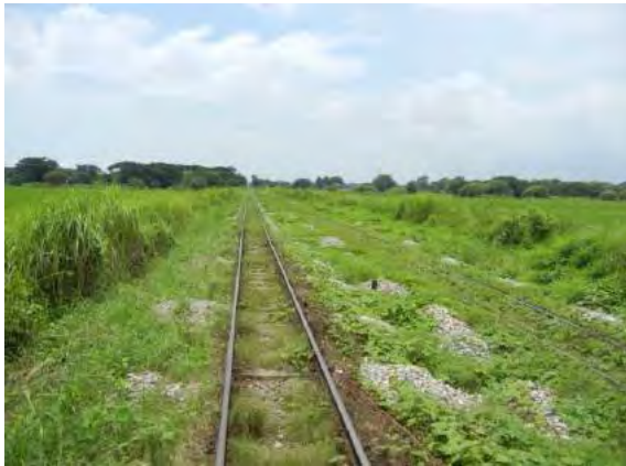
(a) 軟弱地盤の沈下 (Mile 82)
