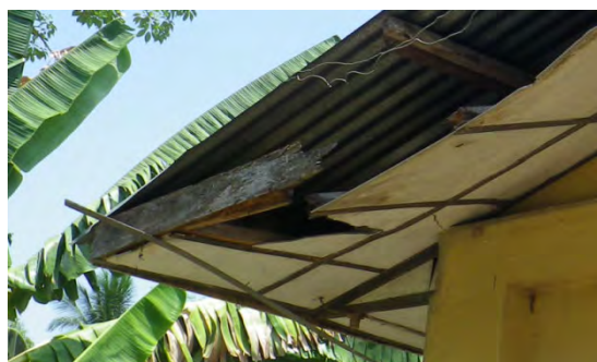
(b) 屋根の損傷
