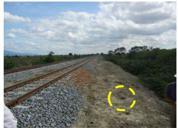
(d) 盛土不良による沈下 (Mile 336)
