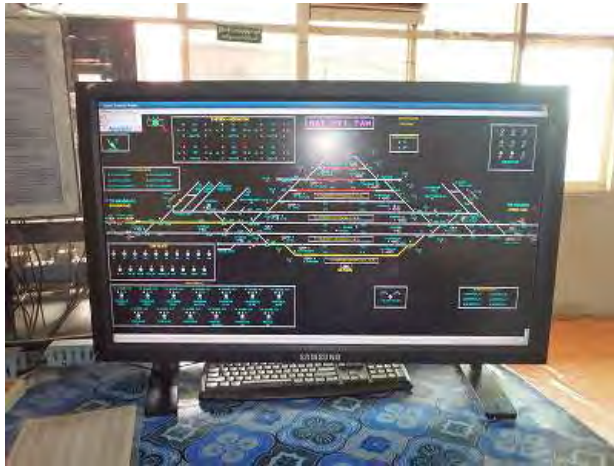
(a) 連動制御盤
