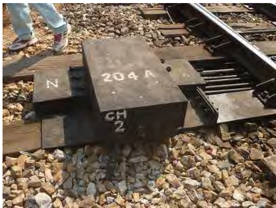
(a) 電気転てつ機 (ネピドー)
