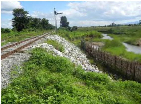
(c) 河川脇の浸食による沈下 (Mile 243)
