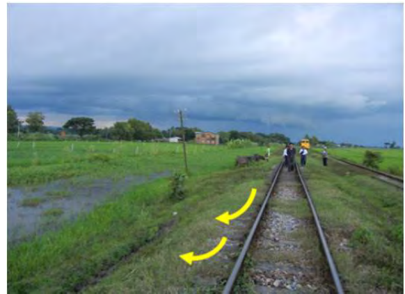
(b) 軟弱地盤の側方流動 (Mile 146)
