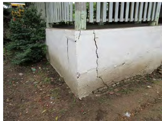
図 5.9.4 基礎のクラック
