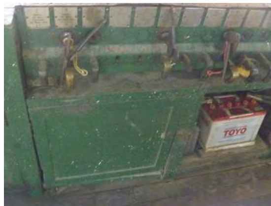
(b) 電気機械連動装置
