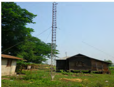
(a) アンテナ設備 (一般駅用)
