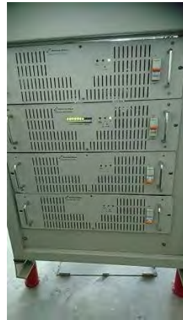
(b) 電源装置
