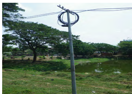
(a) OFC (コンクリート柱添架)
