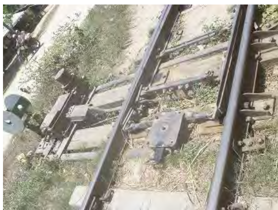
(a) 電気転てつ機とキーロック
