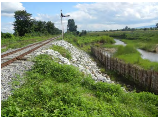
(c) 河川脇の浸食による沈下 (Mile 243)
