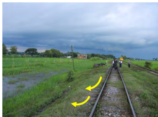
(b) 軟弱地盤の側方流動 (Mile 146)
