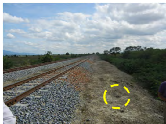
(d) 盛土不良による沈下 (Mile 336)
