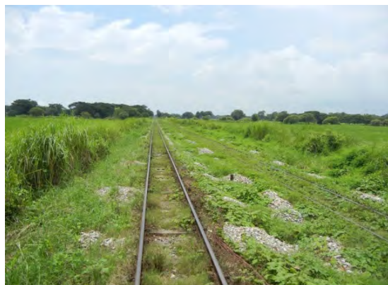
(a) 軟弱地盤の沈下 (Mile 82)
