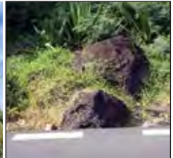
Chute de pierres
