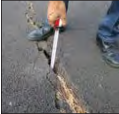
Fissures sur la route
