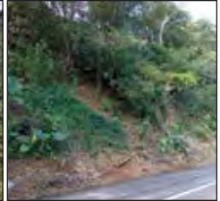
Pente couverte par le sol mou sujette à un effondrement de la pente
