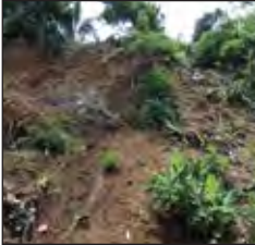
Effondrement de la pente
