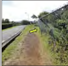
Clôture endommagée par affaissement de la pente
