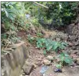
Debris Flow (Baie du Cap)
