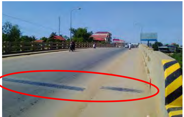
រូបថត ១.៤.១០ Expansion joint
