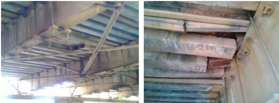
(D) Serious structural defect on steel slab deck (Fatigue crack)
