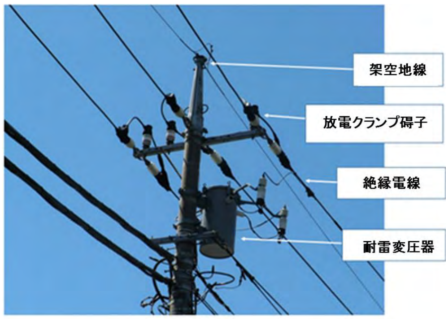
図 9-18 日本における典型的な高圧配電線路
