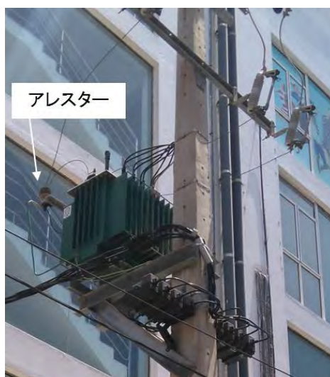
図 9-10 柱上変圧器とアレスター
