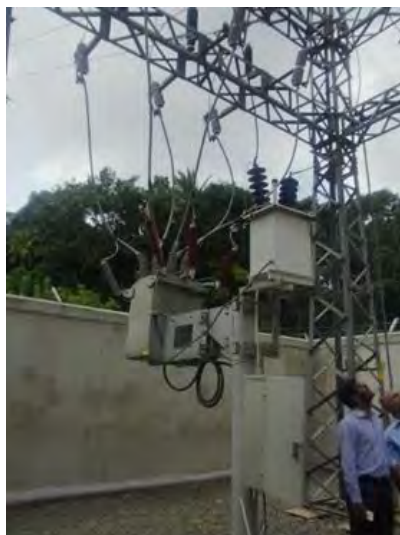
図 9-8 Gantry に設置されたリクローザー
