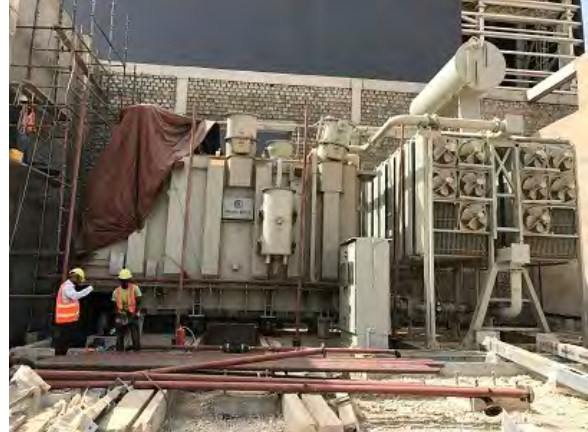
Sendou 火力発電所主変圧器の様子
