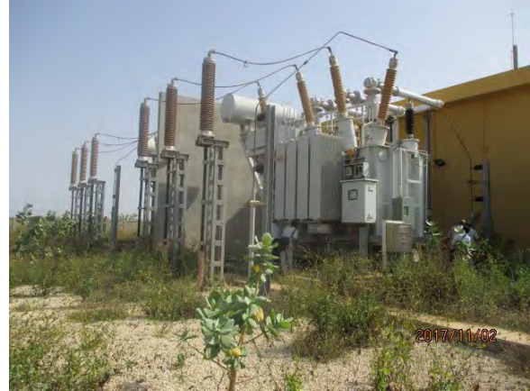
クヌーヌ変電所の様子
