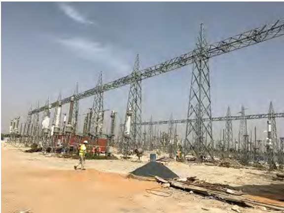
Sendou 火力発電所内 225kV 開閉所の様子
