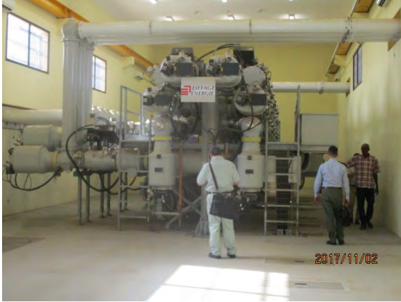
クヌーヌ変電所の様子
