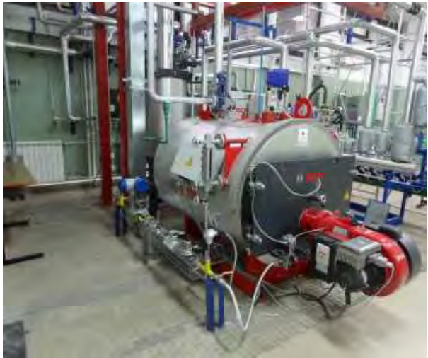
ボイラーユニット
