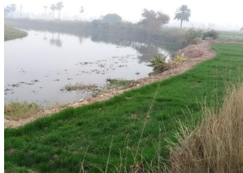
通水ピーク時に流された護岸工 （Dlhans Bridge 村付近）
