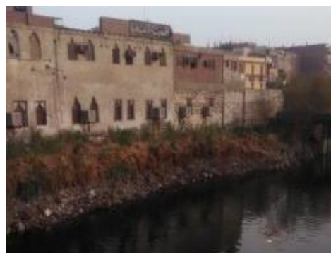
住宅基礎部の洗掘
