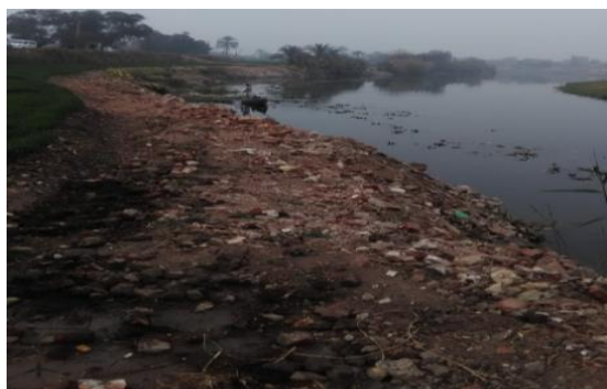
高水位時越流箇所(Dlhans Bridge 村付近)
