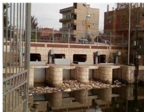
サード堰と上流のゴミ状況
