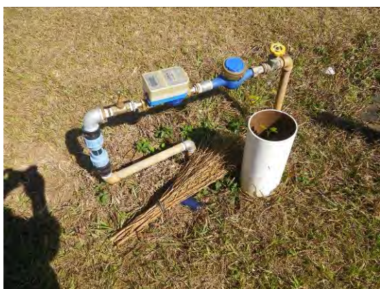
LWB 既存施設 (プリペイド式水道メータ) LWB 本部 (2017/7/22)
