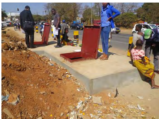
LWB 既存施設 (送水管路弁室) リロングウェ南部地域 (2017/7/26)
