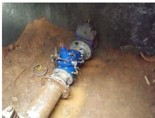
LWB 既存施設 (減圧弁) リロングウェ北部地域 (2017/7/31)
