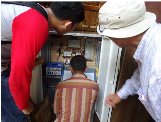
コントロールパネルの操作指導
