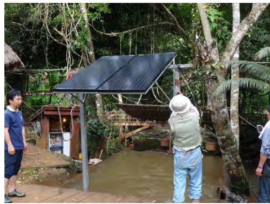
設置されたソーラーパネル
