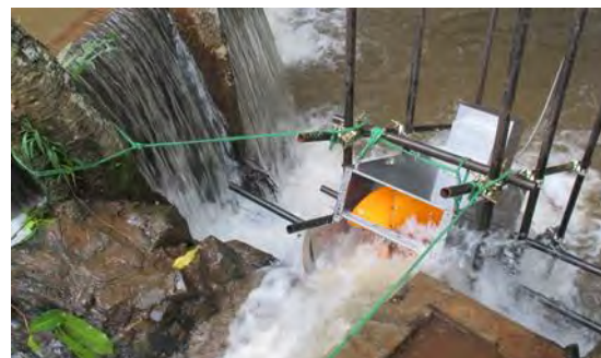
オロミスレストランに設置した発電機
