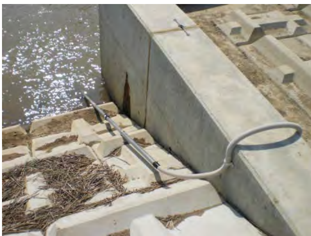
計測機器(水位計)との組み合わせ設置例
