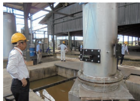
ケニンガウ・パーム油工場内の 山仙式炭化炉
