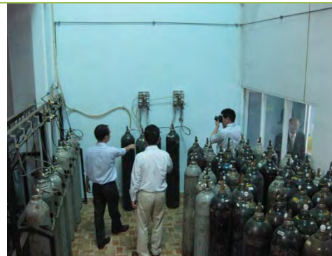
写真-18 : NAFIQAD 地方支局 集中ガス配管と分析用特殊ガスボンベ。施設の入り口にボンベが乱立しており、3階の検査室までビニール管で繋げている。
