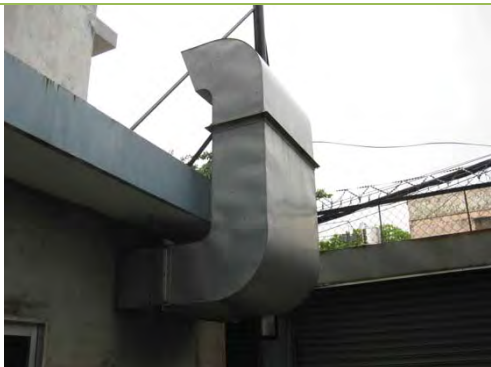
写真-17 : NAFIQAD 地方支局 既存の検査設備、排気設備にスクラバーなどはなく、汎用換気ファンにより外部環境に強制放出している。
