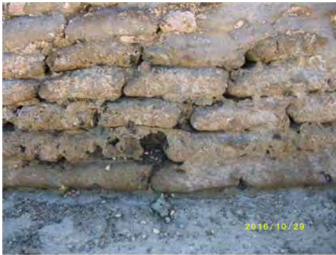
倒壊につながる飛沫帯でのコンクリートの劣化
