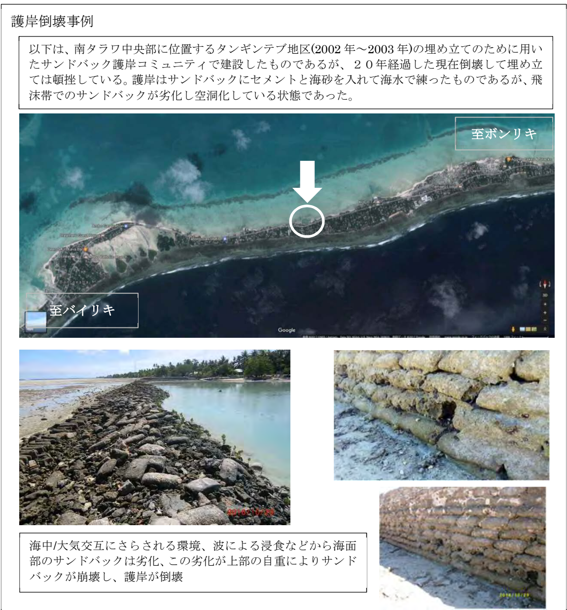
図 3-7 劣化による護岸の倒壊例
