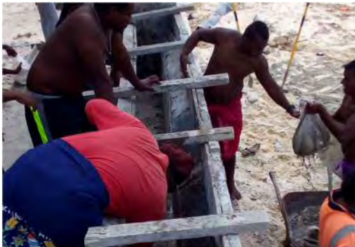
施工不良を招きやすい施工方法
