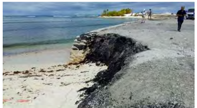
護岸の状況 護岸の脇の陸地がえぐられている
