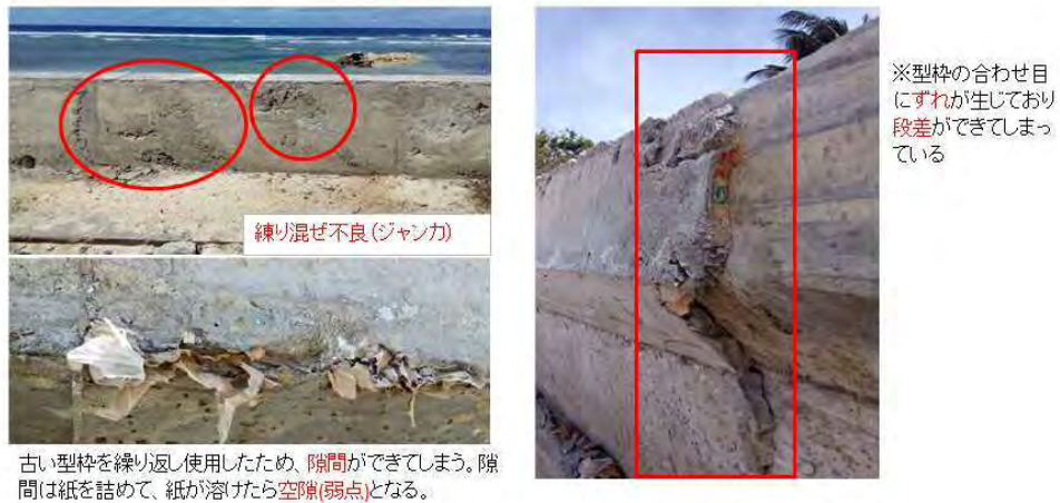
写真－2 施工不良
