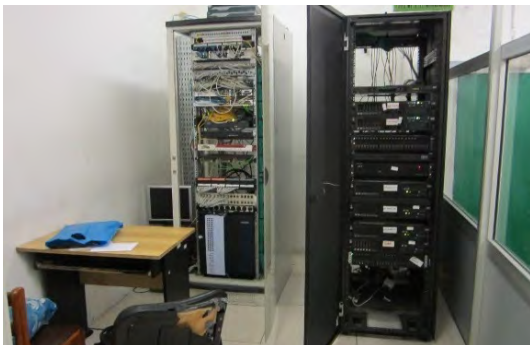
写真-15：サーバールーム。スキャナーを除くアーカイブ機材はこちらに設置する。
