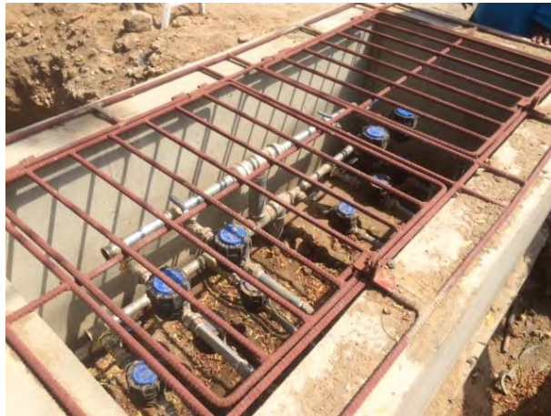
写真 3-10 マカダラ地区に導入されたマニフォールド型給水装置
