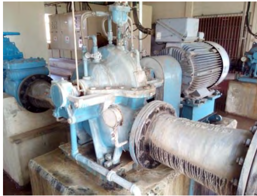
写真 3-22 ポンプ軸水漏れによる石灰分の付着
