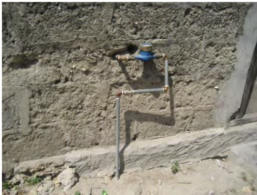
写真 3-8 青銅製水道メーター
