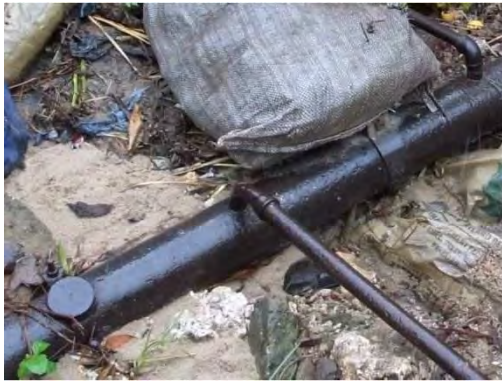
写真 3-6 給水取り出し
