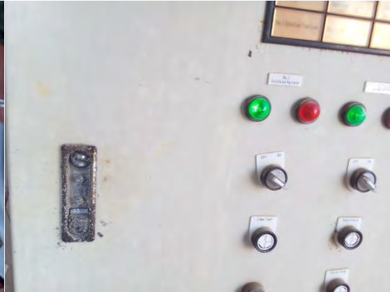
写真 3-21 盤扉取手の腐食
