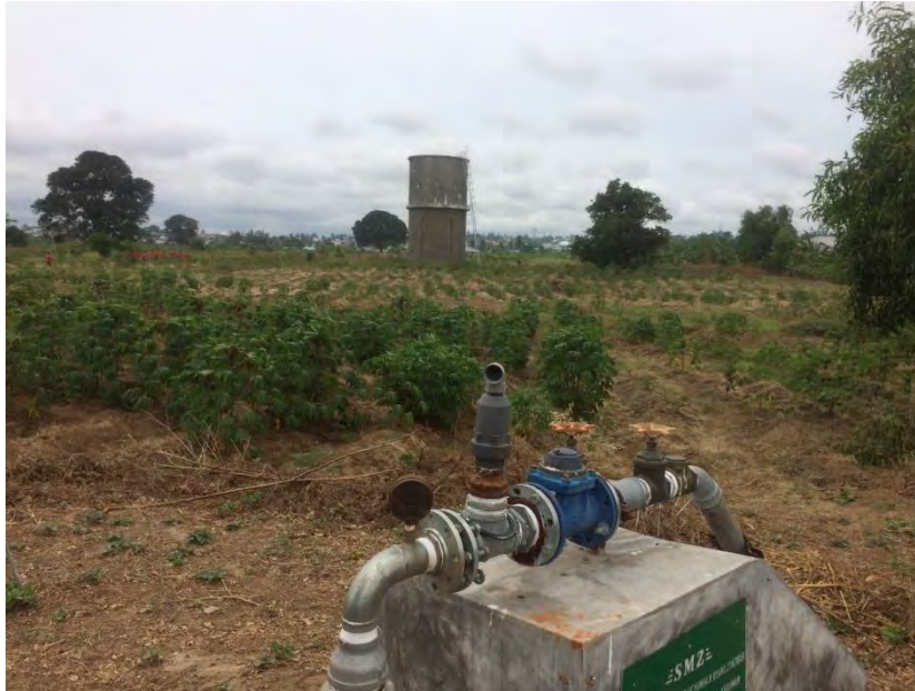
写真 3-1 ザンジバル井戸掘削プロジェクトで建設された井戸と高架水槽
