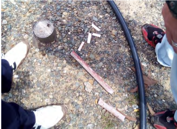
写真 3-20 薬注配管の破損
