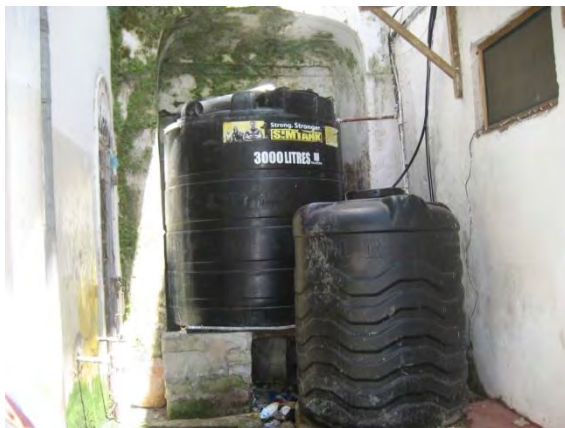
写真 2-3 非公式供給者の貯水タンク
