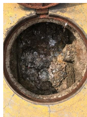
メンテナンスできていない サニーマス
