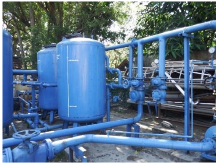
ホテルCの浄化槽ろ過設備
