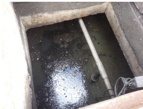
ホテルAに設置されている浄化槽
