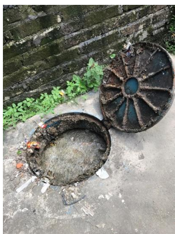
維持管理がされていない サニーマス
