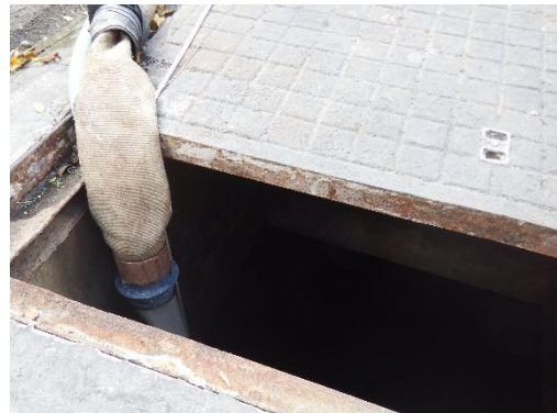
行政基準を満たせていなかったため、一時的にバキューム車で汚水を下水処理施設へ送っている
