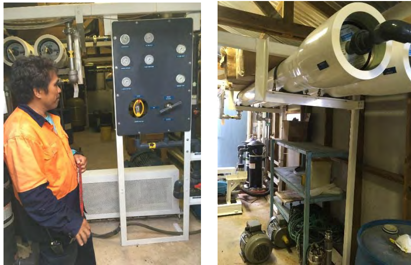
図 1.18 故障したトレーラー式装置（上）と CPUC により改良された海水淡水化装置（下）
