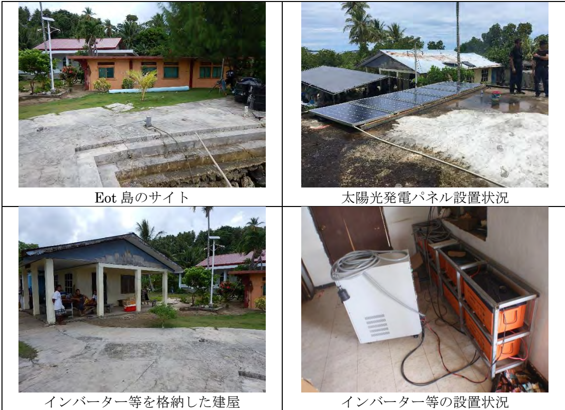
図 3.27 Eot 島におけるウォーター・ステーションの整備状況
