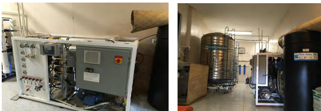
図 1.17 チューク州立病院の RO 浄水装置
