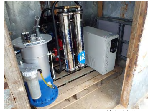
インバーター・バッテリー等保管状況
