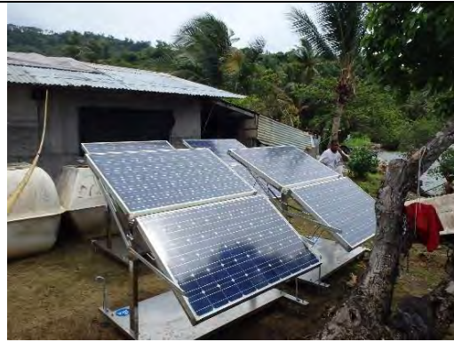
太陽光発電パネル設置状況
