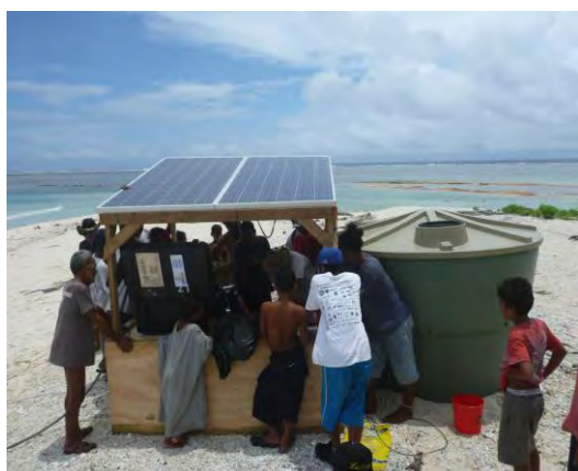
離島に設置された海水淡水化装置
