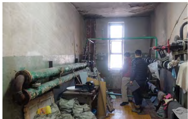
暖房設備室。天井、床、設備機器の老朽化が著しい。
