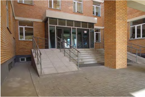
11 番学校：玄関スロープは勾配がきつく床が滑りやすい。
