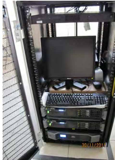
写真 6.3.6 電子基準点のサーバ (内部)
