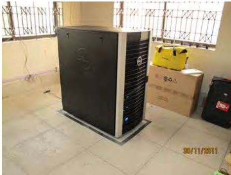
写真 6.3.5 電子基準点のサーバ (外側)
