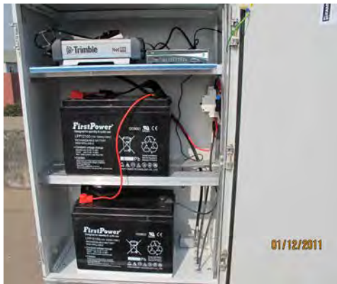
写真 6.3.3 電子基準点 (内部) (受信機、送信機およびバッテリー)
