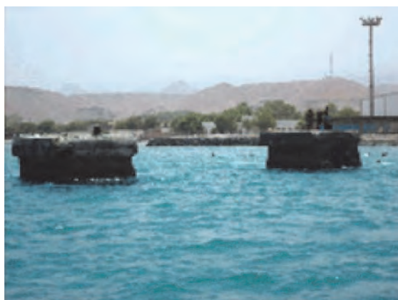
沖側ドルフィンは防舷材欠落
