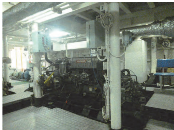
機関室 (一部、小規模計測機器に故障あり)
