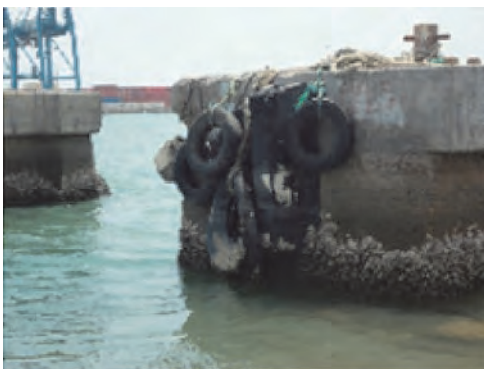
陸側ドルフィン防舷材頭部損傷
