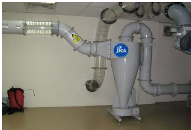
マレーシア NIOSH, MoHR(労働安全衛生センター) No.2(建築物内換気施設:研修用)
