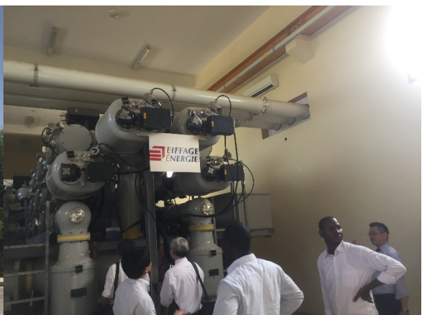
クヌーヌ変電所の既設 225kV GIS
