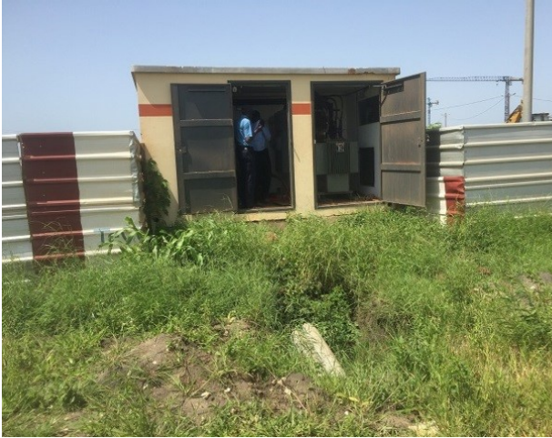
ケイロッド配電用変電所
