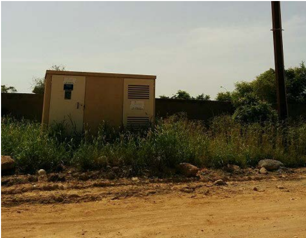
バグニー配電用変電所
