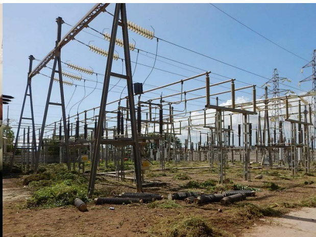
ソコシム既設開閉所の 90kV 開閉設備
