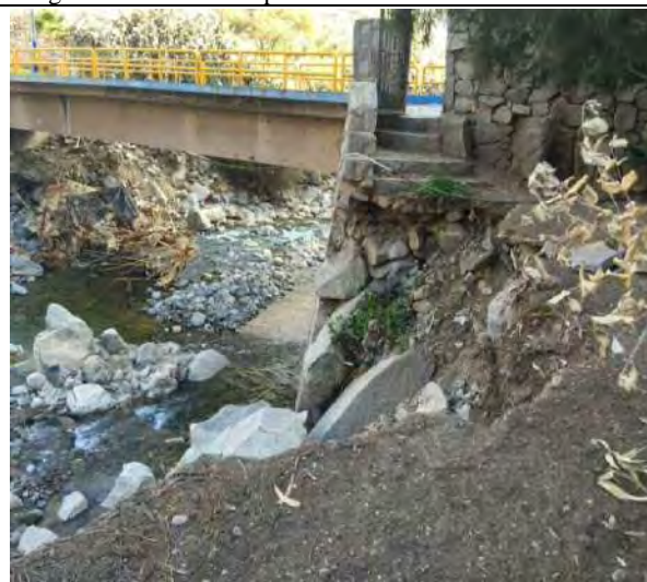
Foto 4: En la foto se puede apreciar como el Rio socaba la estructura del puente cuando hay inundación. Este puente comunica la ciudad de Surco con la carretera principal
