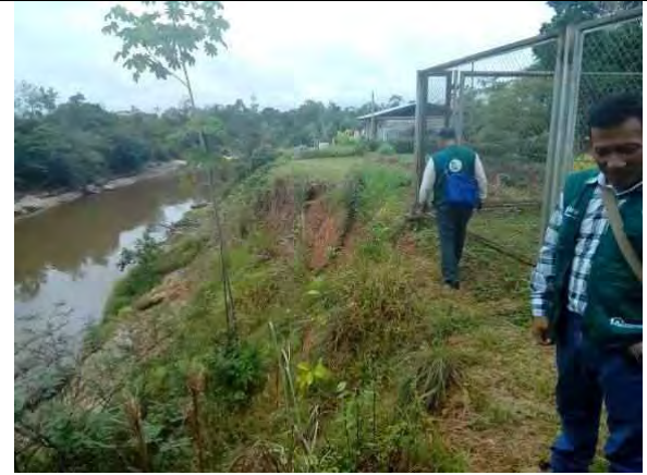
Foto 8: El margen izquierdo del Rio Itaya sufre una erosión que pone en peligro la estructura de la planta de tratamiento de agua que sirve a la Comunidad de Cahuide
