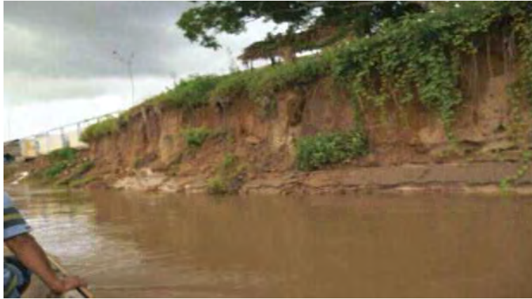
Vista de la erosión de la margen derecha del río Paranapura, sector área urbana del caserío Santa Lucía
