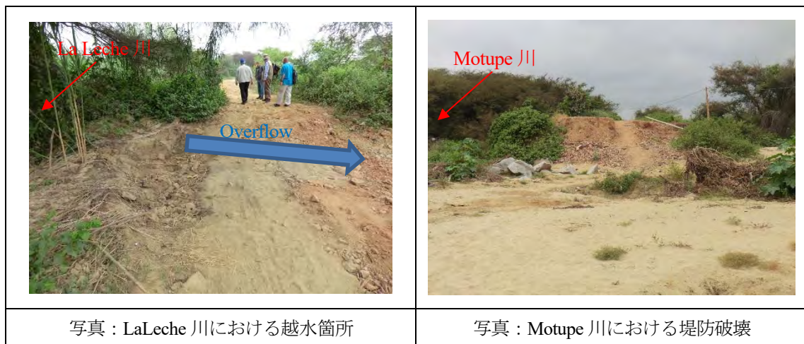
図 13.3.55 La Leche 川及び Motupe 川の洪水越水地点
