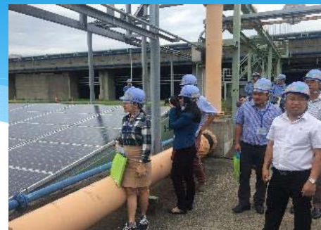
Các tấm pin năng lượng mặt trời làm nắp đậy các bể phản ứng
