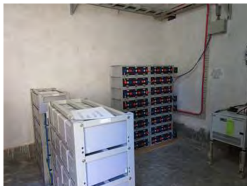
ジャカール電話局機械棟蓄電池室内部
