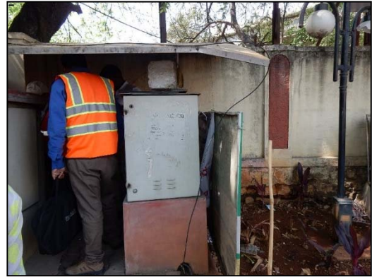
写真-2：MG Road エリア 信号制御機調査（交差点 No.2）
