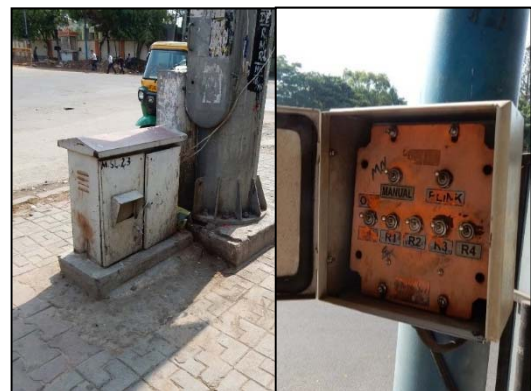
写真- 6：交通信号制御機 地上設置式(左)、頭上式(右)
