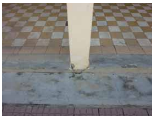
集会室棟のエントランスの正面の柱 床面に亀裂が入っている
