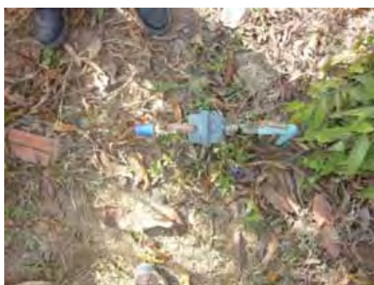
RTTC の敷地の水道メーター
