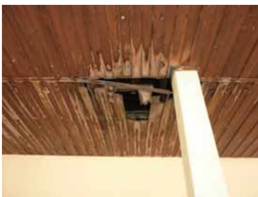
集会室棟エントランス正面天井 天井の欠損と雨漏りによる損傷が 見られる
