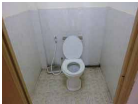
教室棟-3 にあるトイレ 清潔に保たれている
