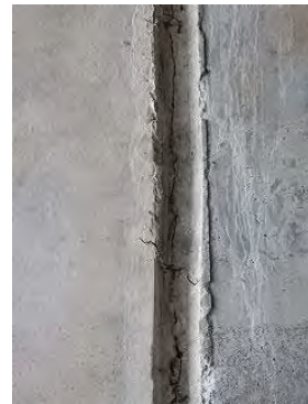
打継目（断面方向）（平成 29 年 3 月）
