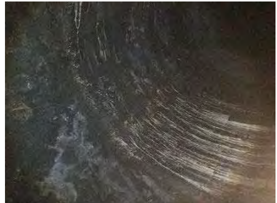
Banonneau の漏水状況(平成 29 年 4 月)
