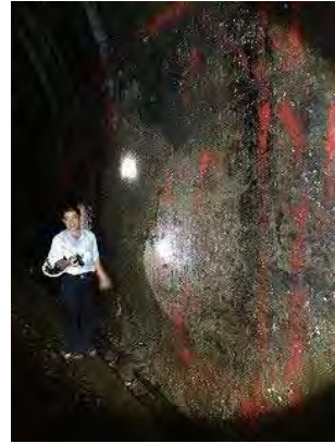
Vung Ro 4 コンクリート脆弱部(平成 29 年 4 月)
