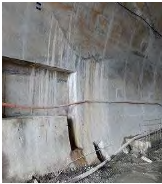
漏水箇所（南側）（平成 29 年 3 月）
