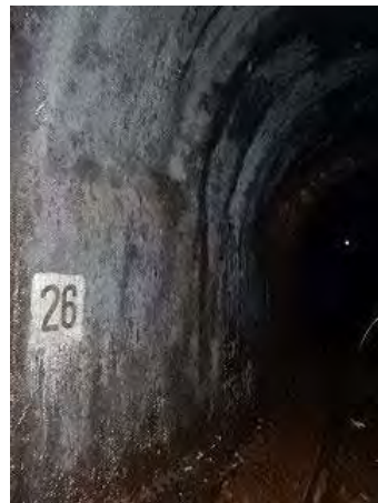
Vung Ro 4 トンネル損傷箇所 (平成 29 年 7 月)
