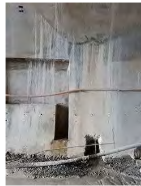
漏水箇所（南側）（平成 29 年 3 月）
