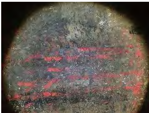
Vung Ro 4 コンクリート脆弱部拡大 (平成 29 年 4 月)
