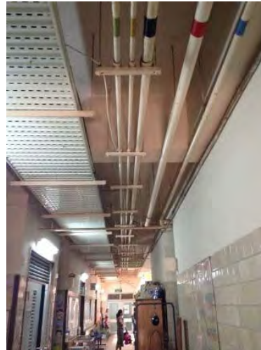
写真 3-3 医療ガス露出配管 （酸素・圧縮空気・吸引）
